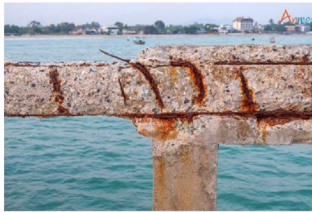
Рис. 1. Железобетонные конструкции, морские сооружения, подверженные коррозии
