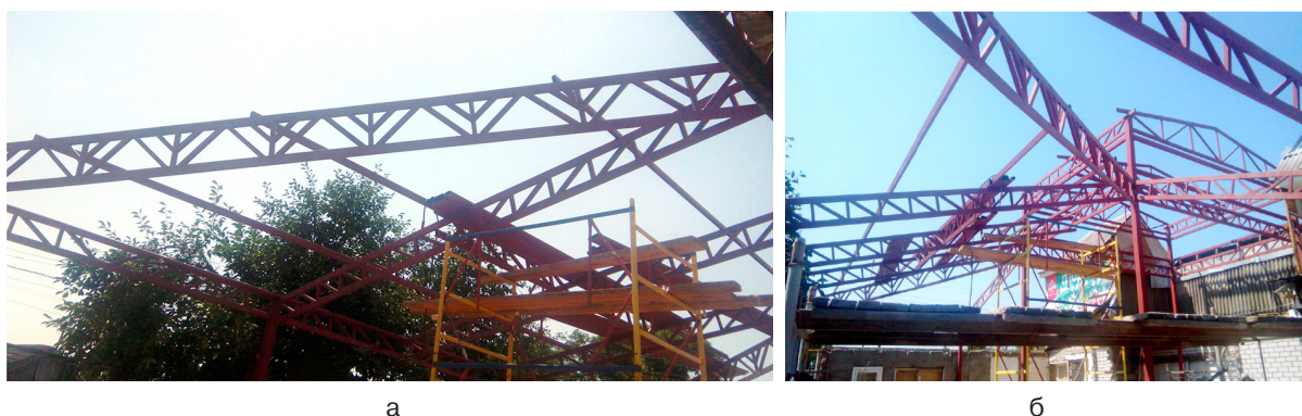
Рис. 3. Снимки ферм покрытия с параллельными поясами и \Psi -образными стойками в треугольных решетках на объекте в одной из станций Ставропольского края: а – в диагональном направлении; б – в ортогональном направлении
