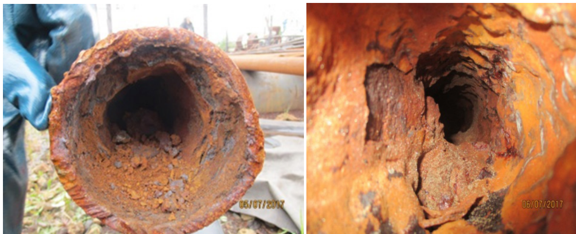
Рис. 1. Участок водовода поддержания пластового давления, подверженный коррозии
